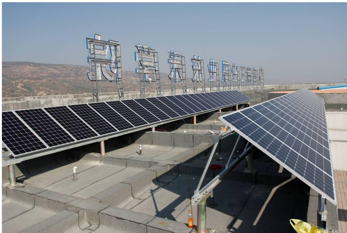
7-1 10KW 光伏发电与建筑一体化示范电站
